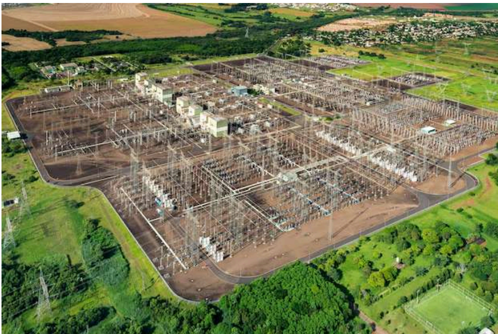
Imatge 56. Subestació elèctrica. Imatge extreta de https://www.freepik.es/fotos-premium/vista-aerea-subestacion-electrica-brasil_124297150.htm
